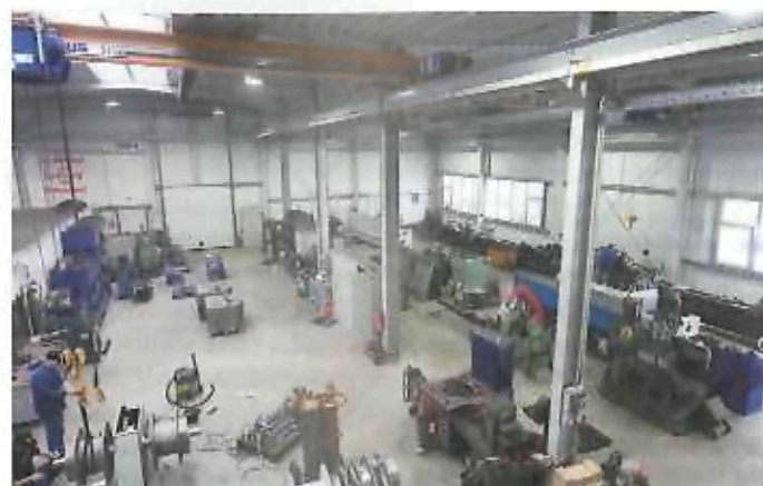
Das unter dem Hallendach installierte Infrarotsystem erwärmt nicht die Luft, sondern Boden und Maschinen.
