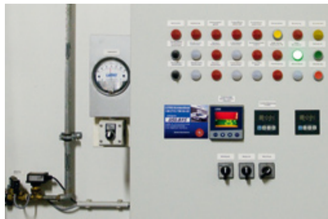
Die Lackieranlage verfügt über Frequenzumrichter und spart je nach Betriebsart bis zu 50% Strom. Quelle: LUTRO
